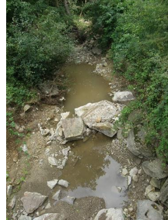
Stojatá voda pod mostom
